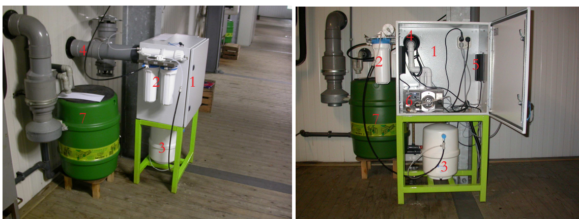
Afbeelding 1 Opstelling Contronics bevochtigingsinstallatie in deze test. Links de gesloten module zoals in bedrijf, rechts een blik in de geopende module 1) gasdichte systeemkast 2) waterfilterunit 3) voorraadvat gefilterd water 4) gecombineerde aanvoer cellucht / afvoer bevochtigde lucht 5) RV sensor/regelaar DRZ-43 6) Ultrasoon bevochtiger HU-25 7) opvangvat voor meting smeltwater van verdamper in de cel (hoort bij de reguliere celinrichting)
